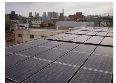
(写真上)設置した太陽光システム
